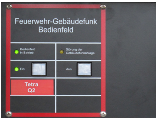
Abb.: MIK NRW Beispiel für ein Feuerwehr Gebäudefunk Bedienteil zur Aktivierung einer TETRA-Funkanlage
